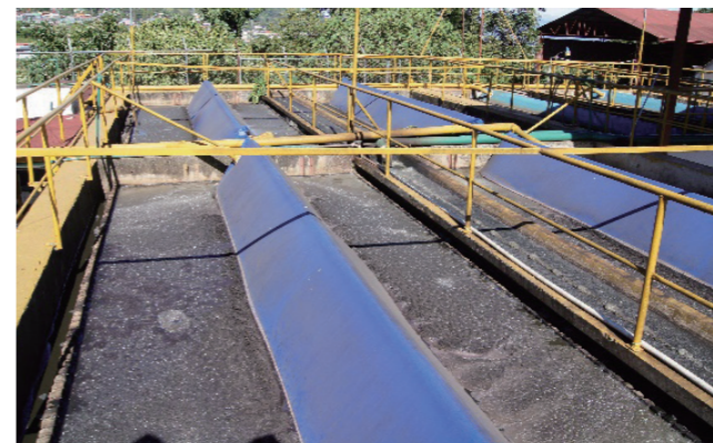
コスタリカの排水浄化・利用設備
